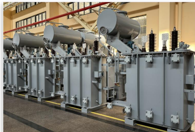
D13-3150 Power transformer
