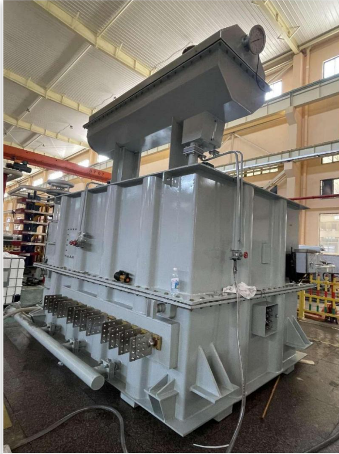
ZHSFPT-12750/35 Rectifier transformer
